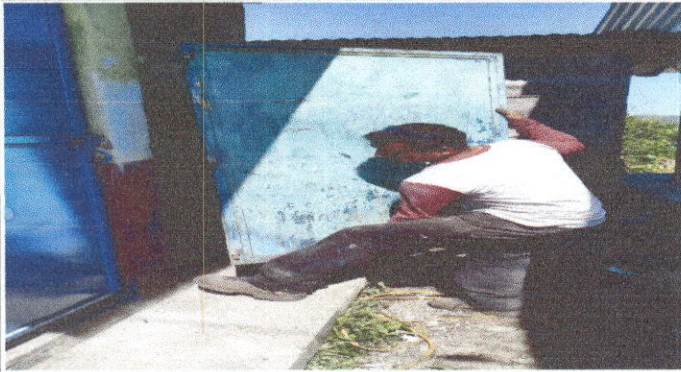
Foto1: Mantenimiento a estructura puertas (lijado, cambio de tubo , cepillado, sujeciones, aplicación de pintura), modulo de baños.
